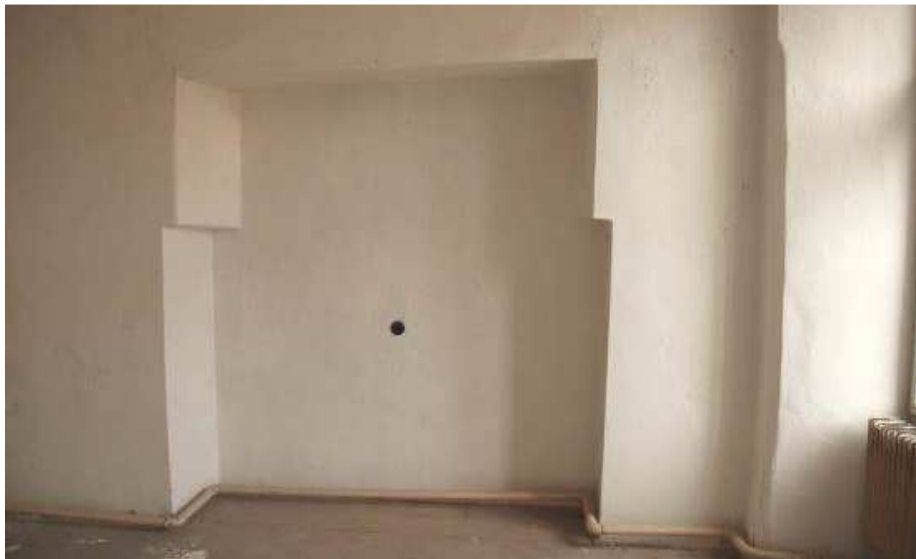
Obr. 20n21: Nika ve stěně 1.04d (foto 2018).
