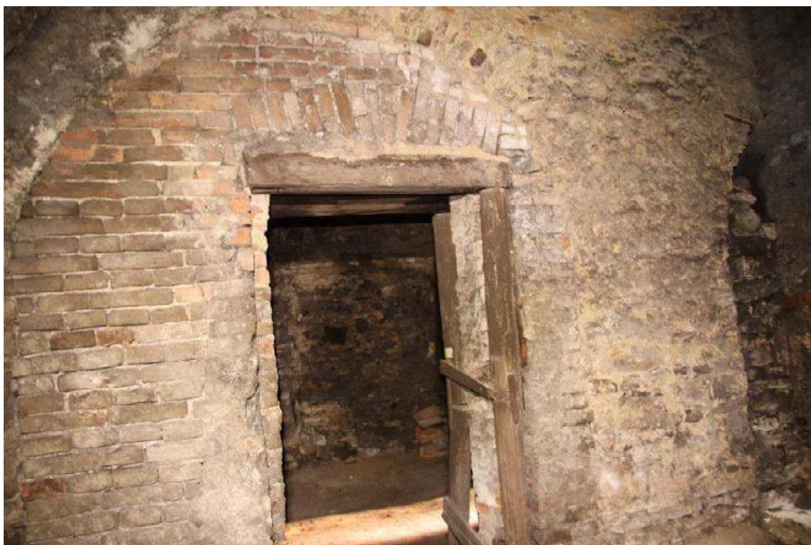
Obr. 15: Stěna S.01c s patrnými klenebními pasy, podepřenými pilířem, a zazdívkami (foto 2018).
