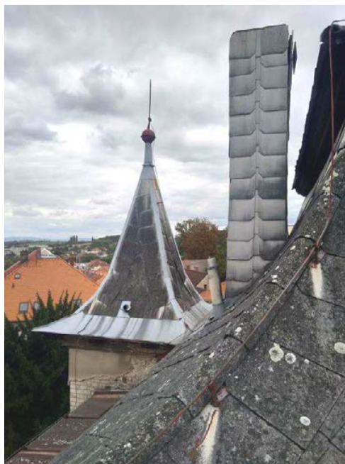
Obr. 14: Pohled ze západu na stanovou střechu rizalitu, pultovou střechu pavlače, komín a vláknocementové šablony na střeše hlavní stavby (foto 2018).
