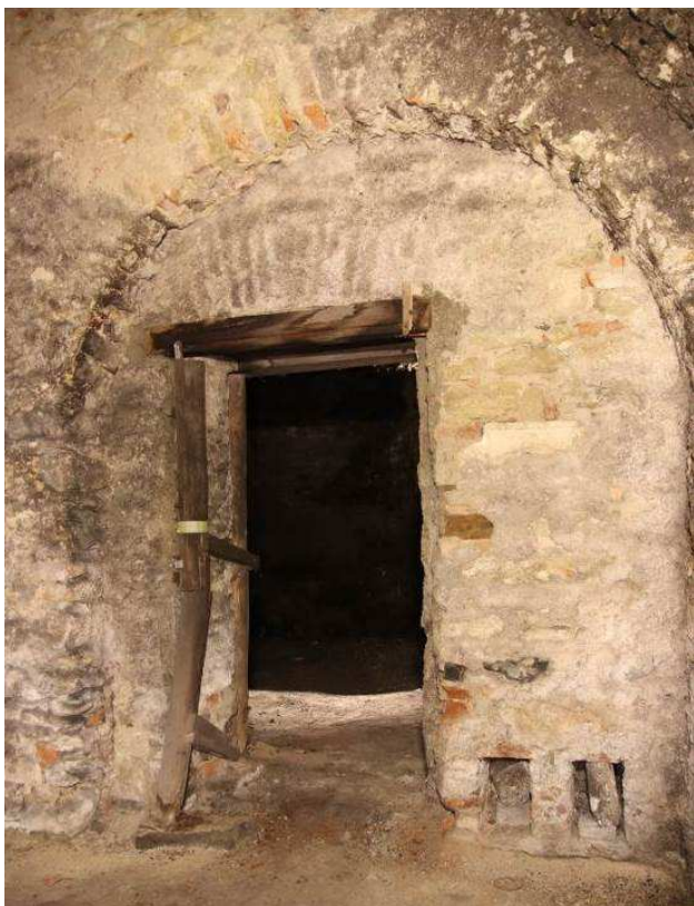
Obr. 16: Stěna S.03a s patrným klenebním pasem a zazdívkou (foto 2018).
