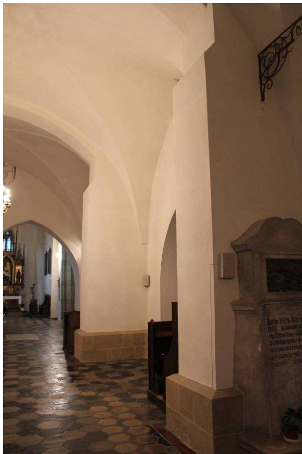
47. Čáslav, kostel sv. Petra a Pavla, jižní stěna severní přístavby s dochovanými opěrnými pilíři trojlodí, pohled od západu. Foto: autor.
