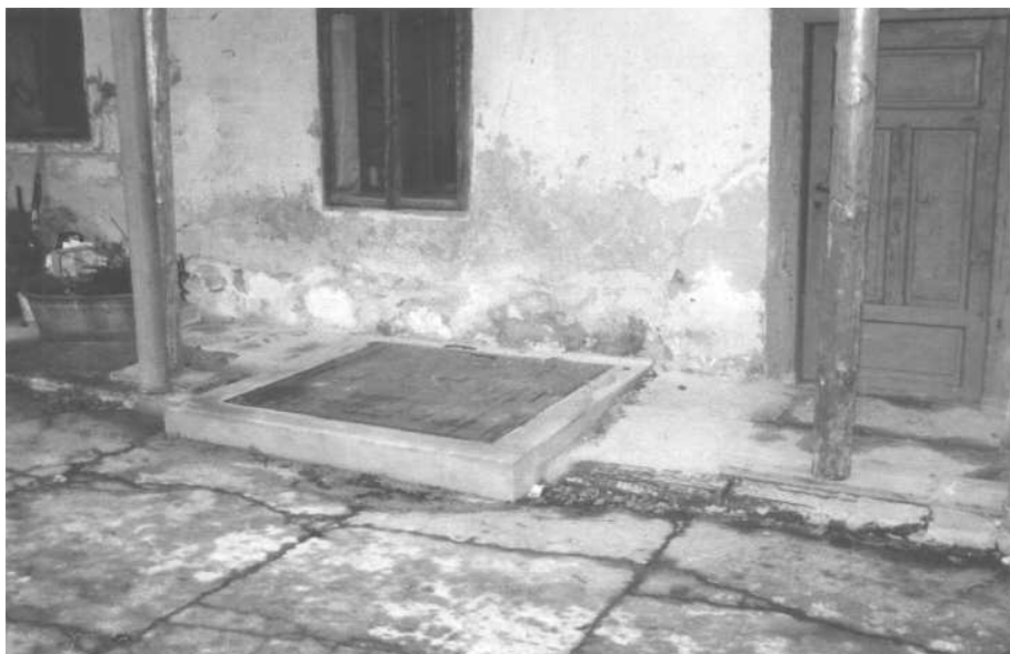
Stav po zabezpečení propadu (únor 1992).
