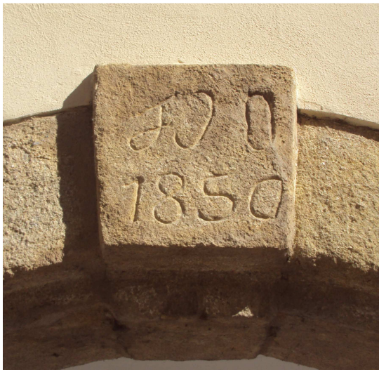
Kutná Hora čp. 373, klenák portálu poškozený a chybně doplněný při opravě fasády domu roku 1996 (foto 2017).
