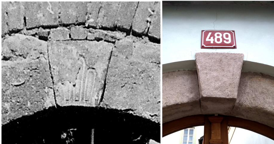
Kutná Hora, klenák portálu v ohradní zdi u domu čp. 489. Reliefní motiv na čelní straně klenáku byl při opravě překryt potěrem (foto 1994 a 2019).
